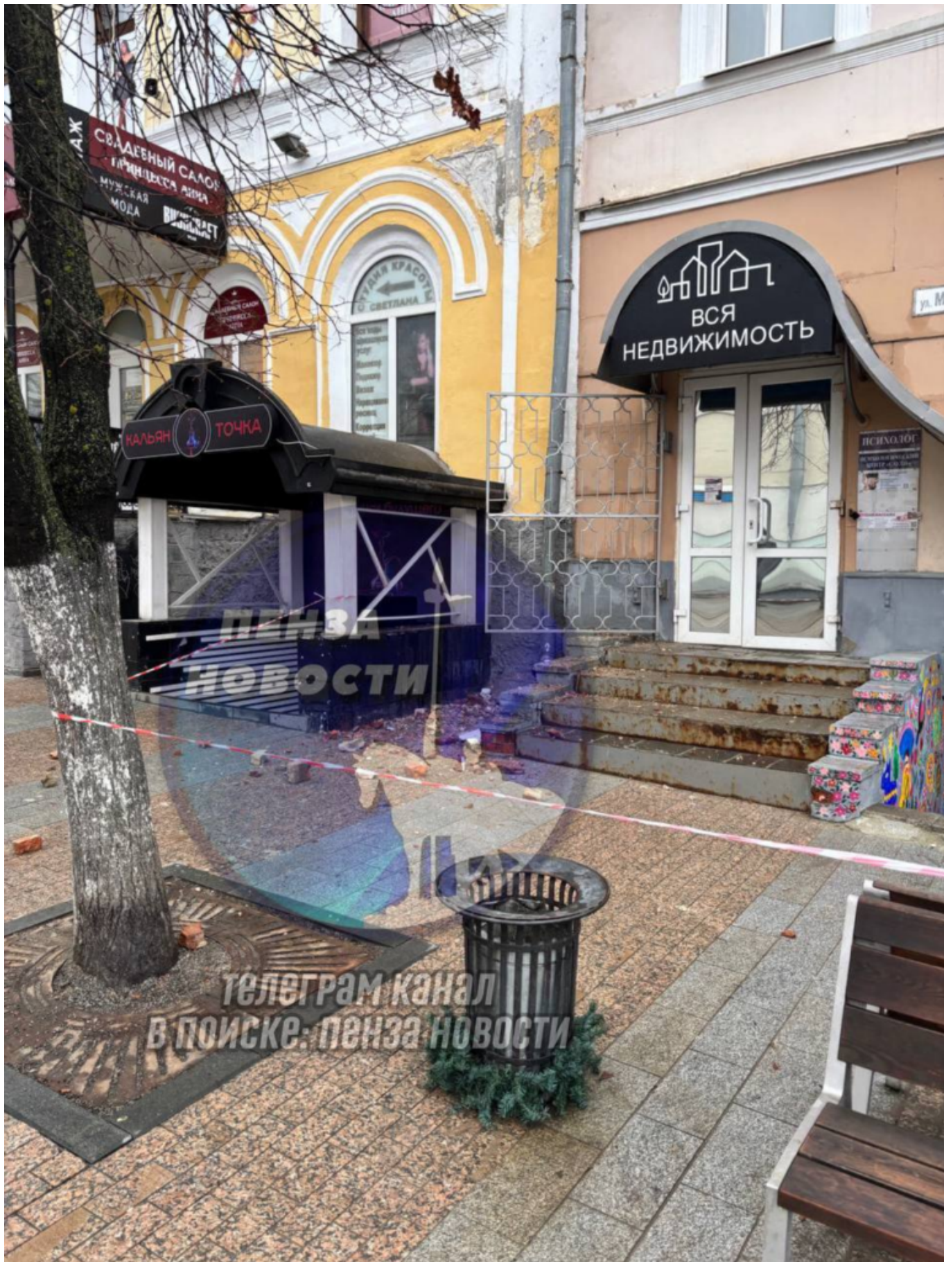
Недавно МедиаПенза писала о происшествии в центре Пензы. Со здания на улице Карла Маркса на тротуар обрушились кирпичи.
